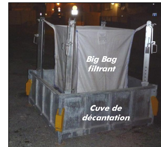
Poste de récupération de laitance de béton Source : Artifex
